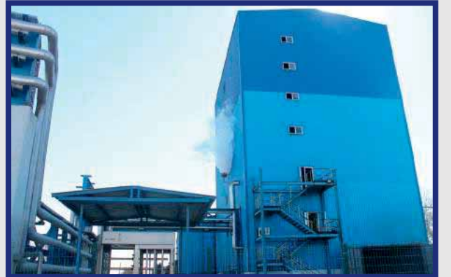
LİLA KAĞIT / ÇORLU 30 Ton/h 20 Barg 240°C
